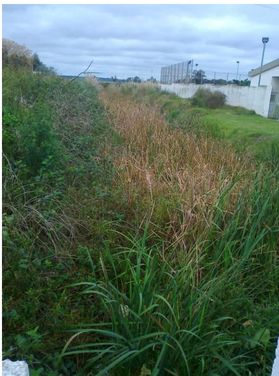
Canal Pluvial en Delta del Tigre con crecimiento de vegetación descontrolado
