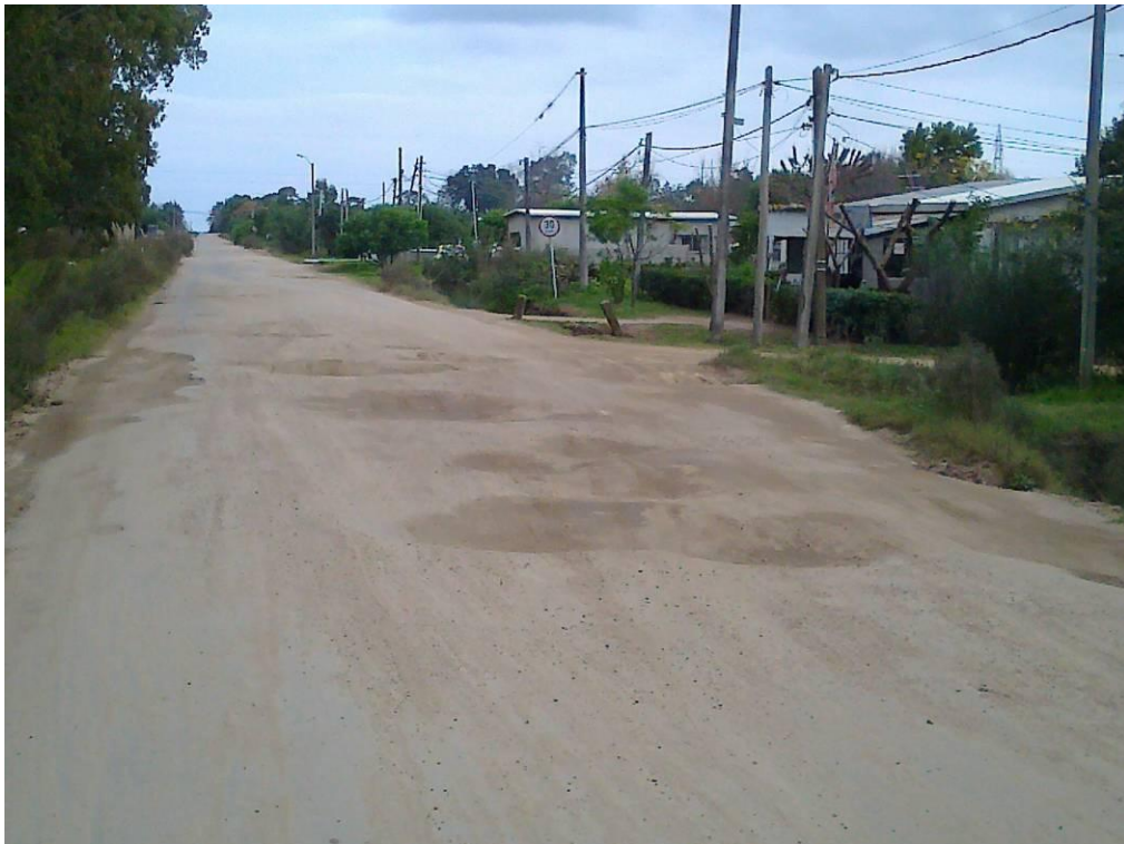
Pozos y baches en vía de salida de una Cantera de la zona.
